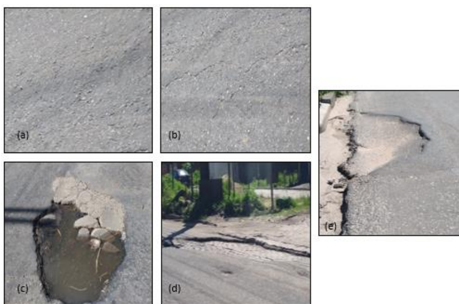
Figura 07: a) Desgaste, b) Fissura c) Panela ou Buraco d) Desgaste Acentuado e) Afundamento Local.
