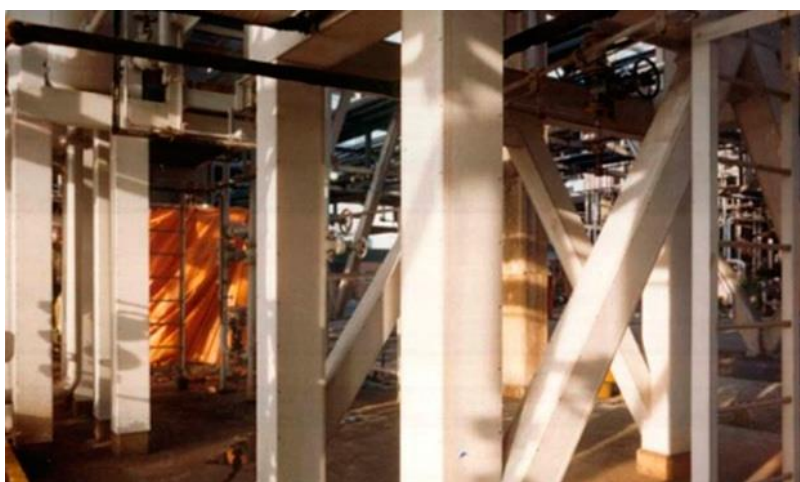
Figura 2.7 – Proteção passiva conta incêndio através de painéis de silicato de cálcio
