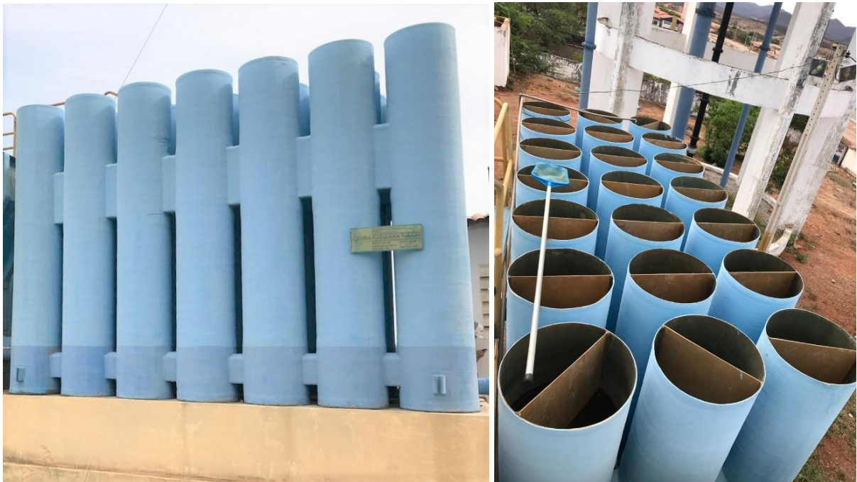
Figura 13 – Floculador mecanizado da ETA
