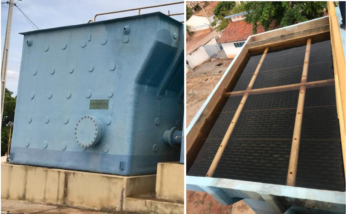
Figura 14 – Decantador de alta taxa da ETA
