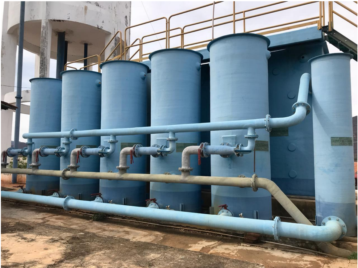
Figura 15 – Filtros descendentes da ETA
