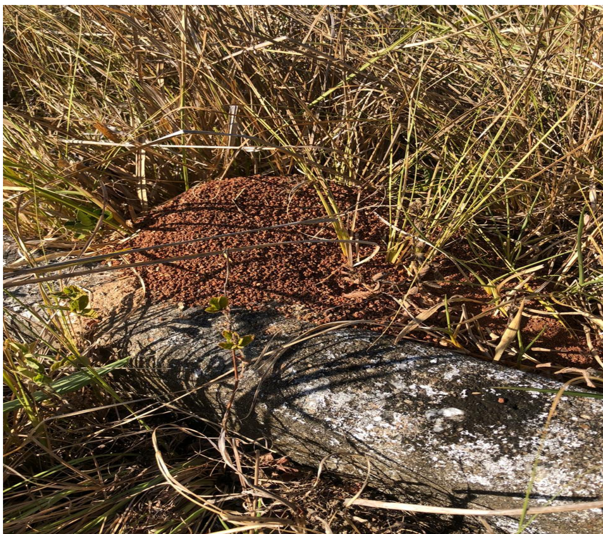
Figura 4 – Formigueiros no talude
