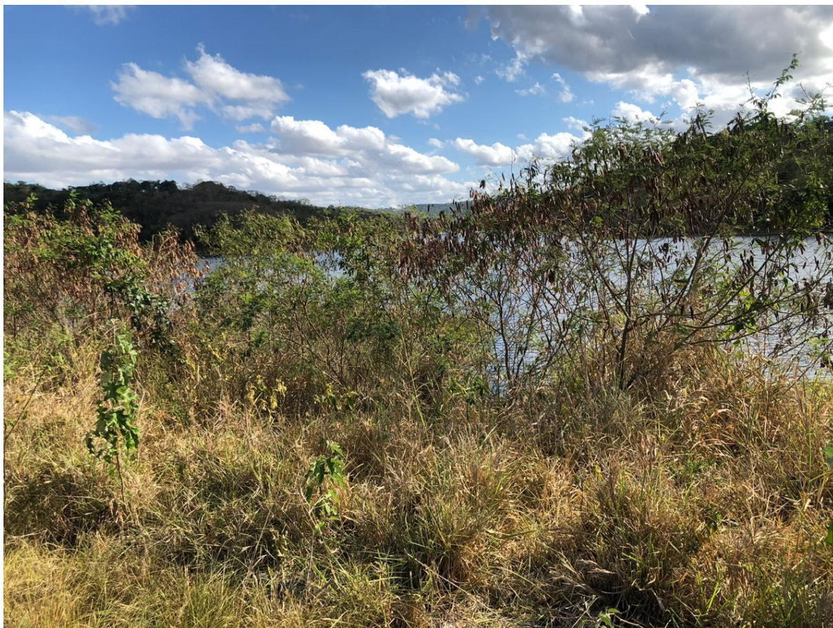
Figura 6 – Vegetação inadequada dos taludes
