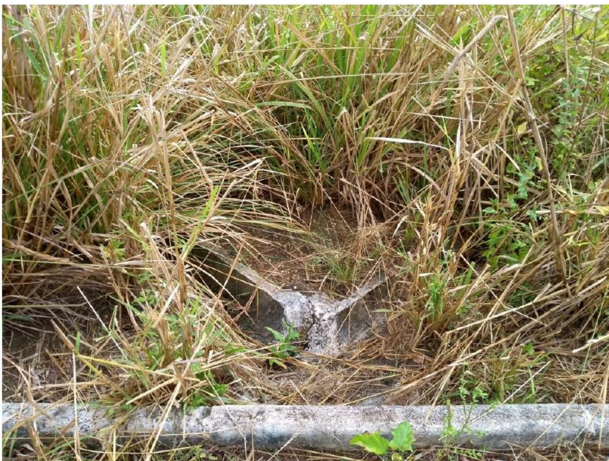
Figura 5 – Canaleta de drenagem obstruída
