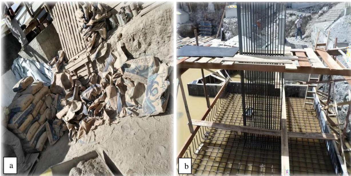
Figura 14: a) descarte inadequado, b) alagamento nas sapatas.
