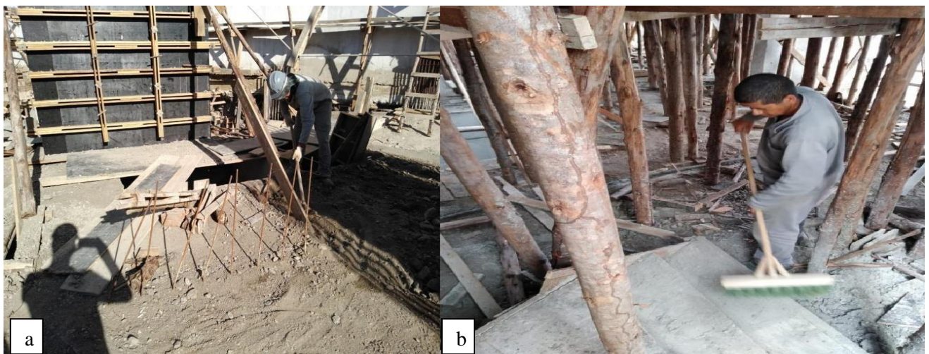
Figura 15: a) Ferragem sem proteção, b) Falta de EPIs do colaborador.
