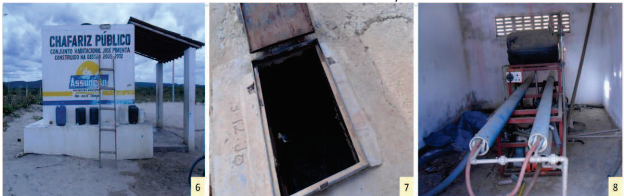
Figuras 06, 07 e 08: Condições do sistema de abastecimento de água coletivo por meio do Chafariz Público da Cidade de Assunção-PB
