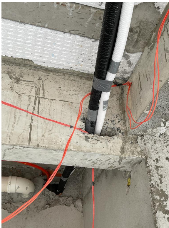
Figura 53 – Furo em viga, realizado para passagens de tubulações.
