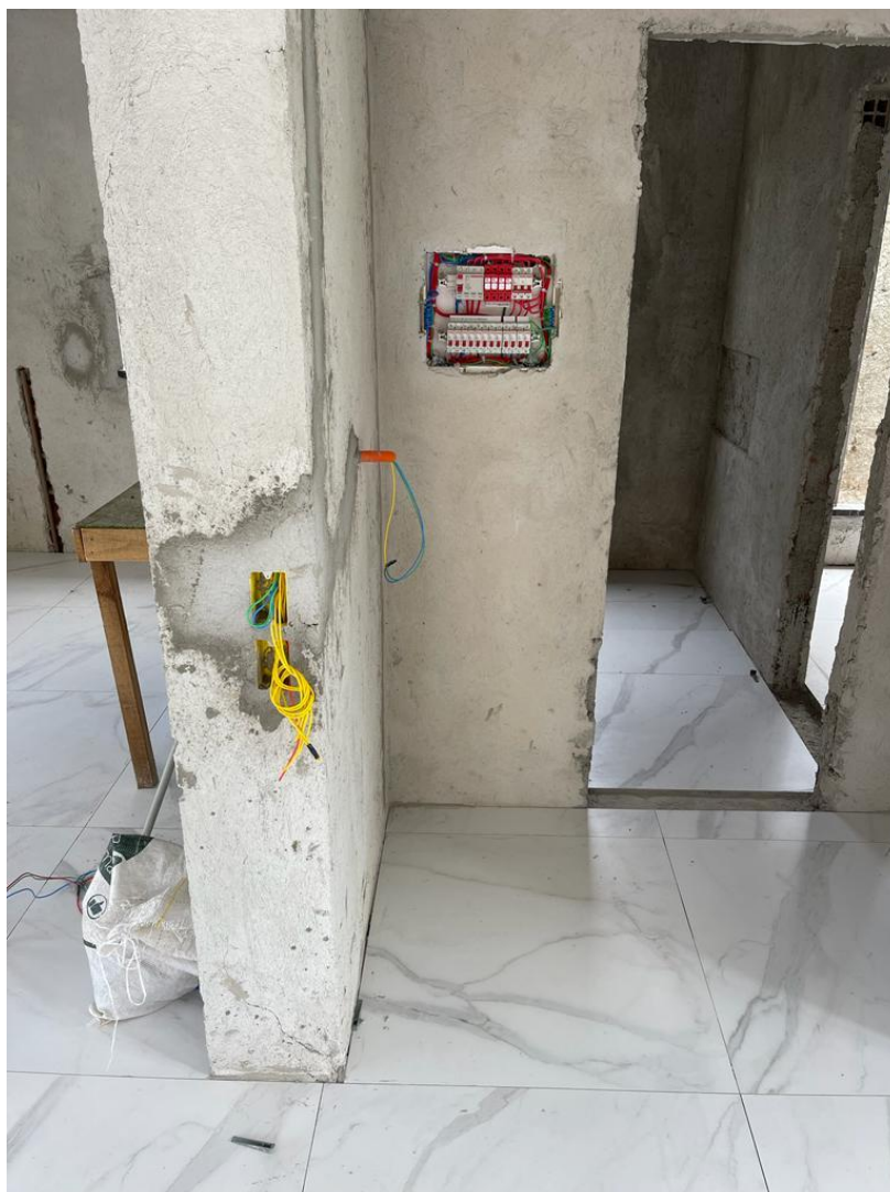
Figura 51 – Locação de interruptores em alinhamento vertical, e não horizontal.
