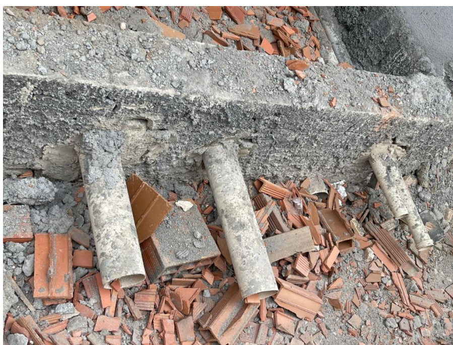
Figura 58 – Tubulações hidrossanitárias cruzando a viga baldrame.
