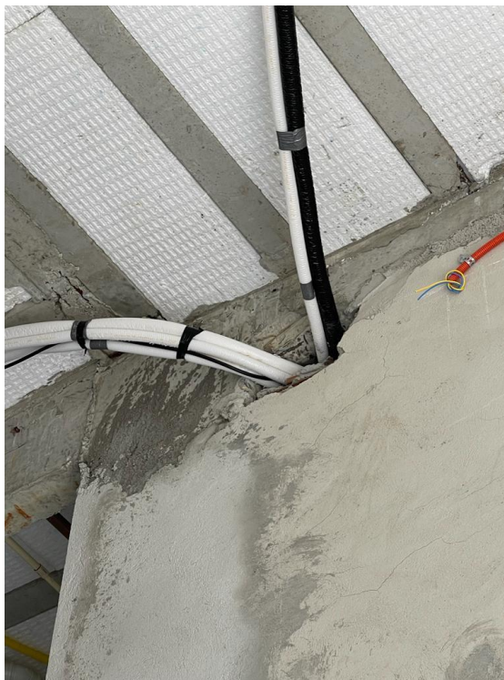
Figura 52 – Furo em viga, realizado para passagens de tubulações.
