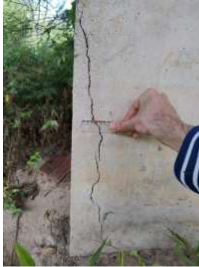
Figura 29 – Exemplificação da medição de abertura de fissuras nos pilares
