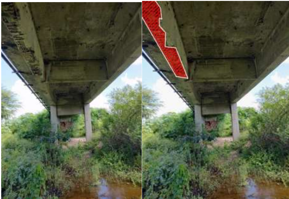
Figura 38 – Corrosão em estágio avançado na longarina
