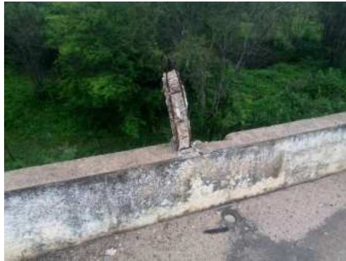
Figura 35 – Deterioração do guarda-corpo e defeitos no revestimento asfáltico
