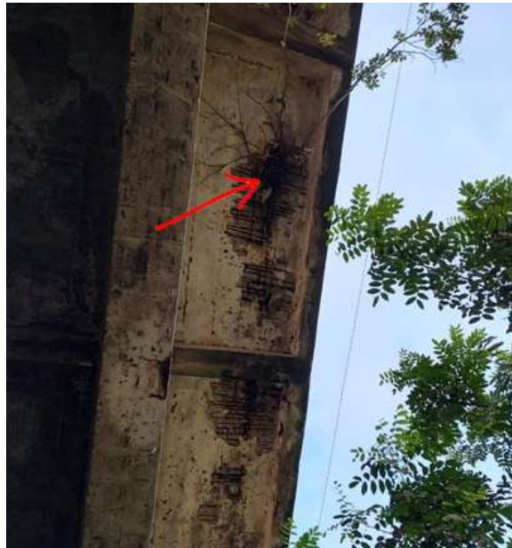
Figura 47 – Local onde foi presenciado o gotejamento
