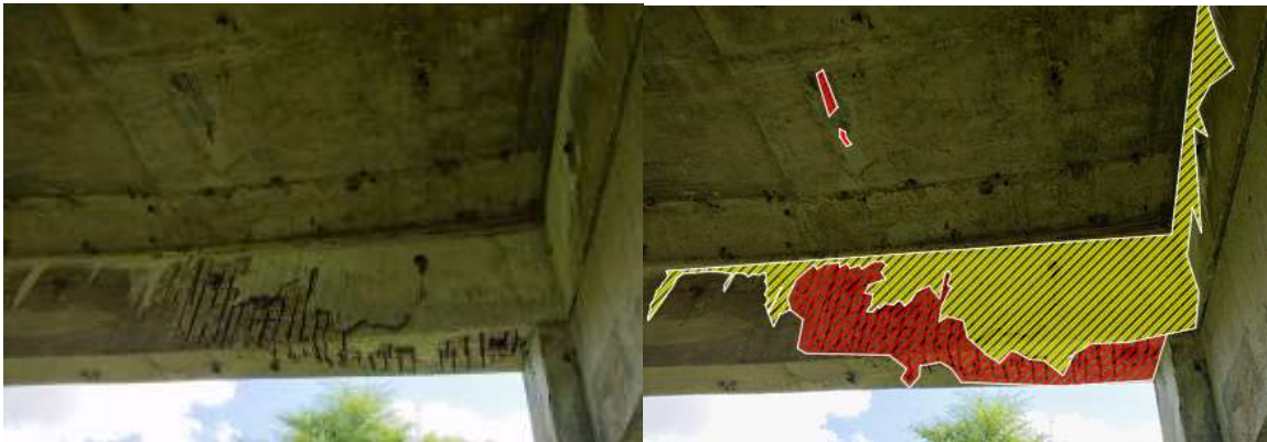
Figura 37 – Eflorescência, deslocamento e corrosão em estágio avançado
