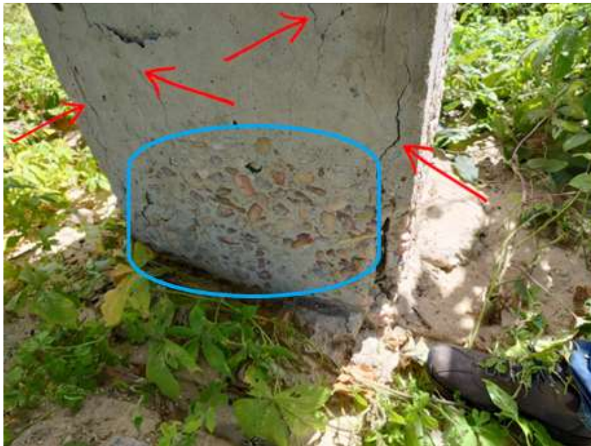
Figura 36 – Segregação e fissuração do concreto
