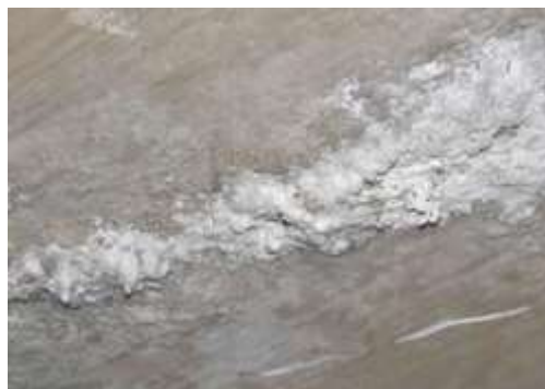
Figura 19 – Eflorescência em estrutura de concreto
