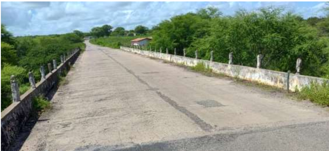
Figura 34 – Acúmulo de vegetação e solo sobre a ponte
