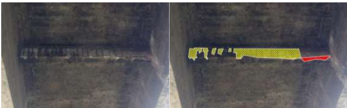
Figura 48 – Eflorescência na transversina da ponte
