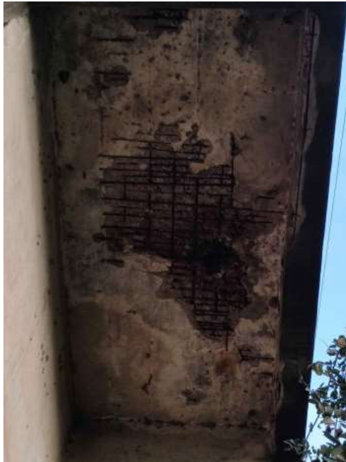
Figura 45 – Corrosão do tabuleiro
