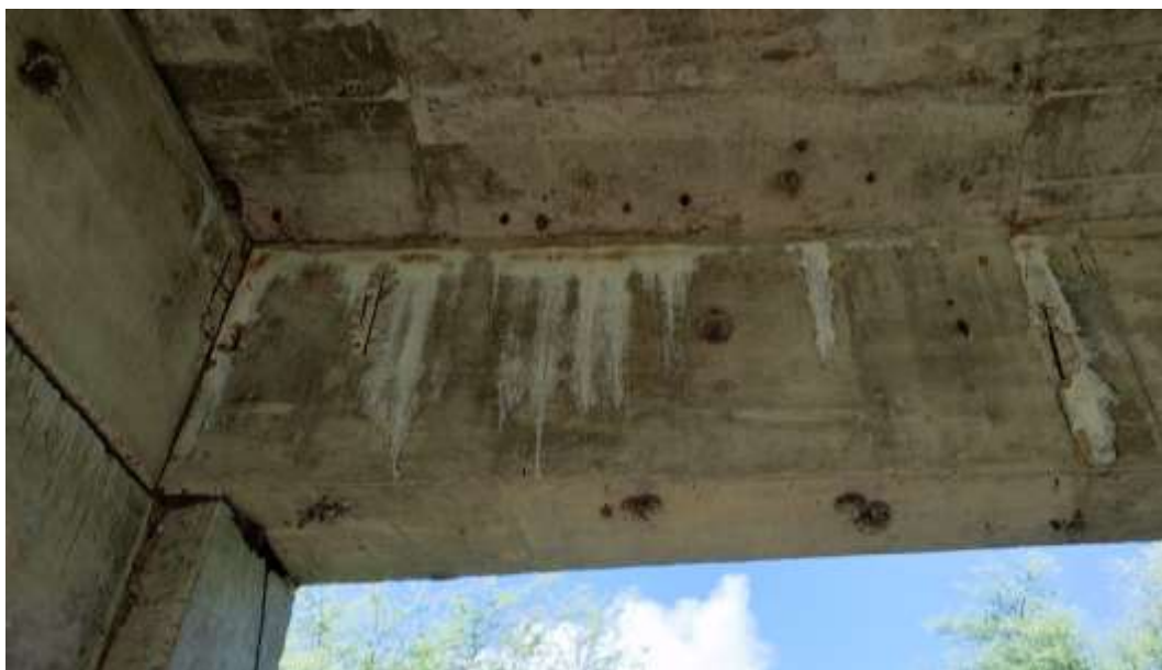
Figura 32 – Eflorescência, corrosão e deslocamento do concreto
