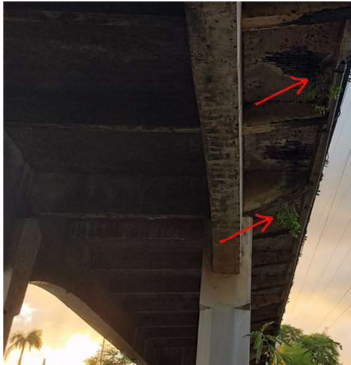
Figura 46 – Presença de plantas na face inferior da laje do tabuleiro
