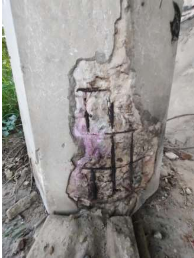
Figura 52 – Comportamento do pilar após o ensaio com fenolftaleína
