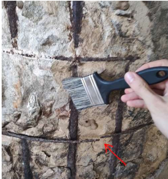
Figura 51 – Estribo rompido por corrosão
