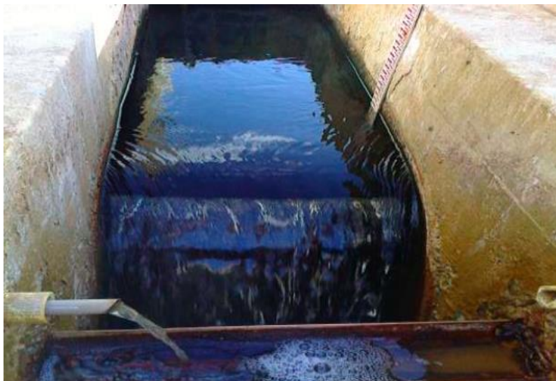
Figura 15 – Chegada da água na ETA, no município de Cacimba de Dentro
