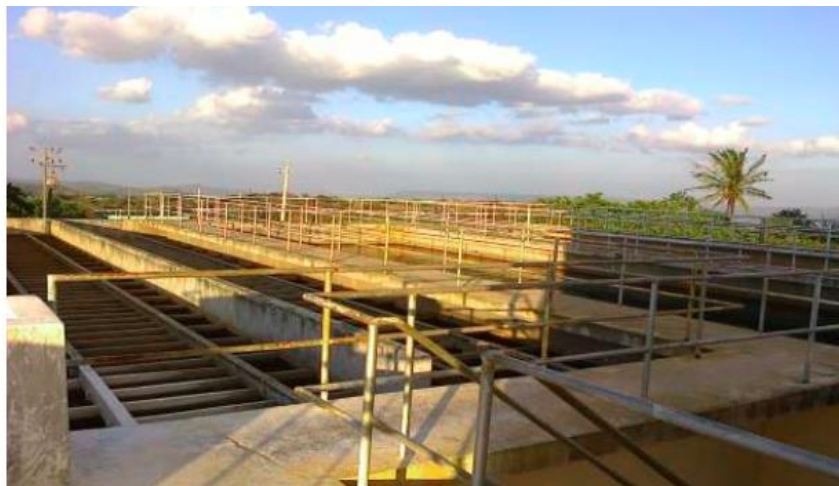
Figura 16 – Flocculador mecânico na ETA, no município de Cacimba de Dentro
