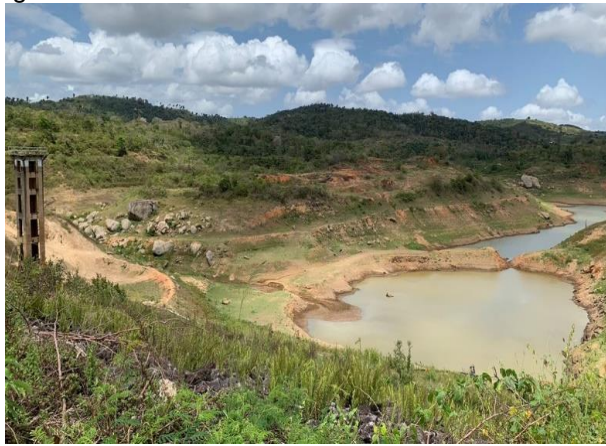
Figura 13 – Barragem Canafístula II em 26 de setembro de 2021 em colapso.
