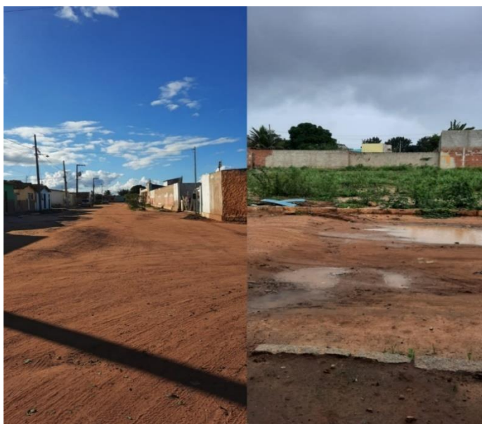
Figura 21 – Vias sem pavimentação na região 3
