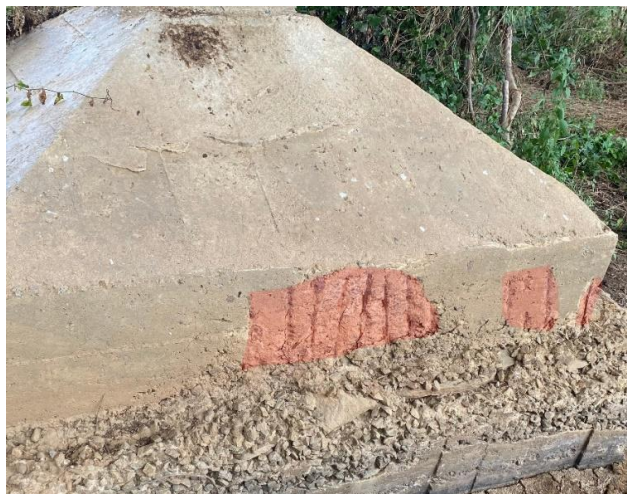
Figura 31 – Início de corrosão na sapata do pilar P7
