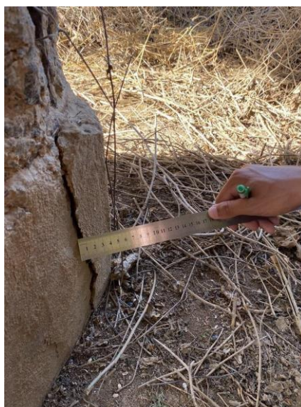
Figura 24 – Aferição de fissuras em um pilar
