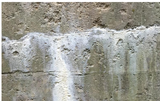
Figura 8 – Eflorescência no concreto gerada pelo fenômeno de lixiviação
