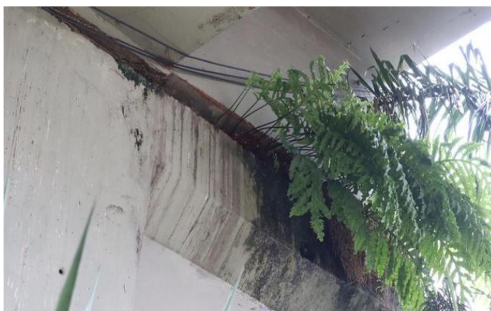
Figura 12 – Vegetação crescendo no interior de uma estrutura
