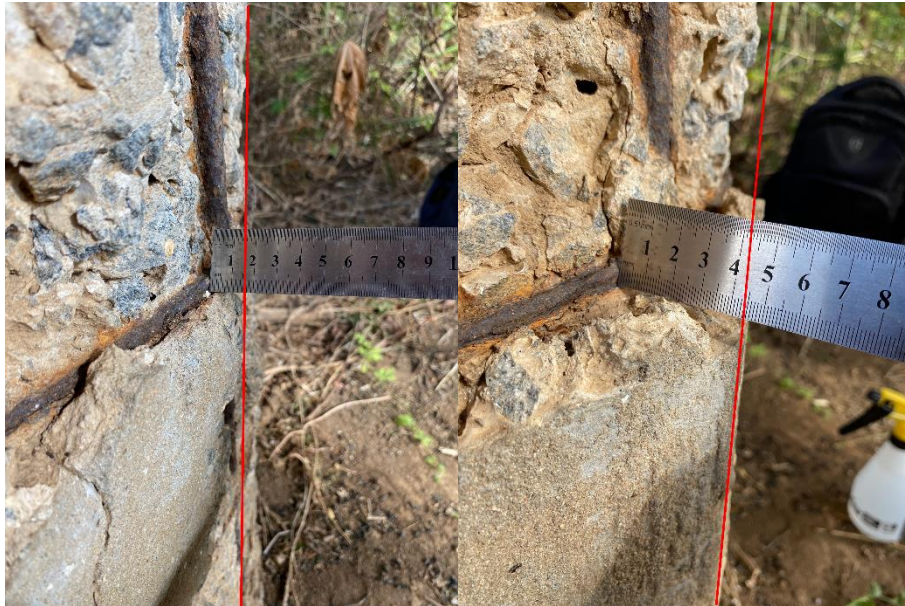
Figura 38 – Medição de cobrimento mínimo e máximo, respectivamente, no pilar P1
