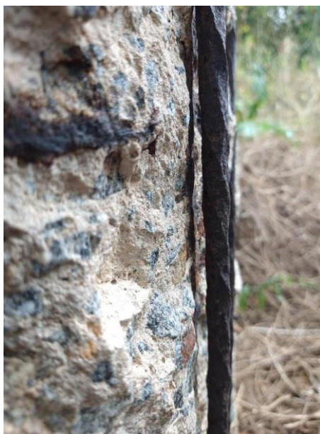
Figura 34 – Armadura principal sem aderência ao concreto
