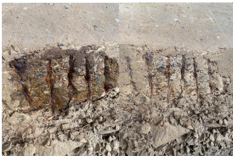
Figura 32 – Durante e após o ensaio com fenolftaleína na sapata do pilar P7
