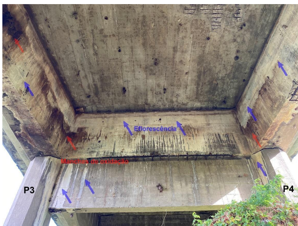
Figura 40 – Manchas de eflorescência e de oxidação em vigas transversais
