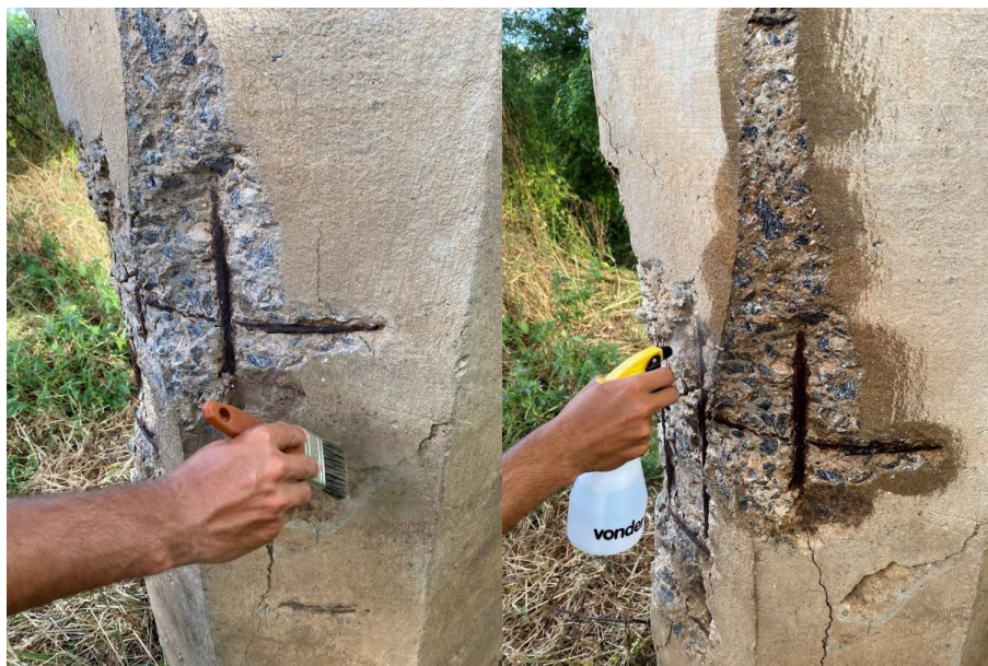
Figura 21 – Limpeza e aspersão de fenolftaleína para detectar carbonatação no concreto
