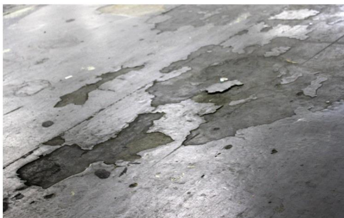
Figura 6 – Erosão causada por abrasão superficial
