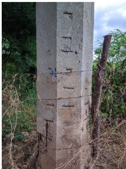
Figura 39 – Degradação dos estribos sujeitos a cobrimento inferior ao mínimo no pilar P5
