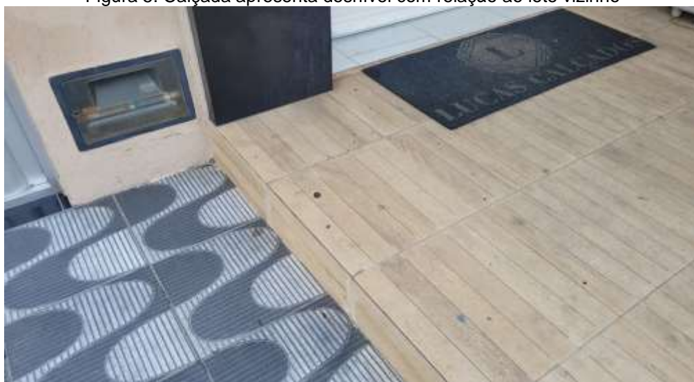
Figura 5: Calçada apresenta desnível com relação ao lote vizinho
