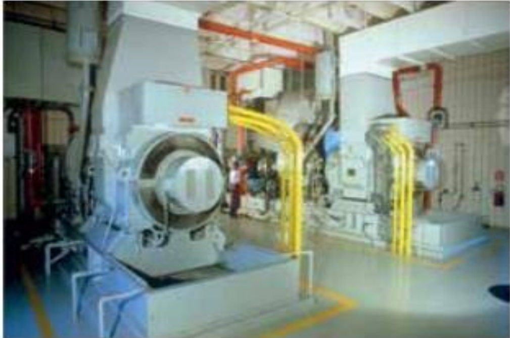
Figura 4 – Turbina a gás
