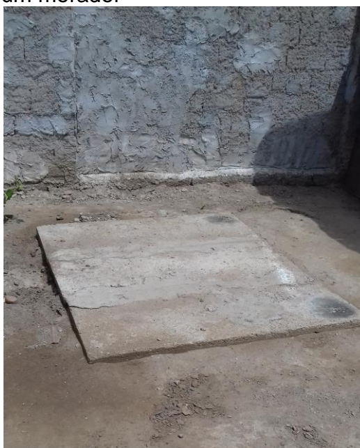
Figura 4- Fossa sépticas da casa de um morador
