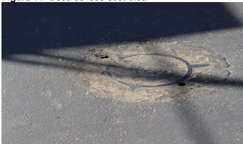
Figura 11- Boca de lobo obstruída
