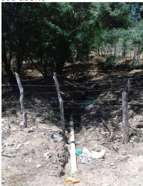
Figura 6- Local onde há esgoto a céu aberto
