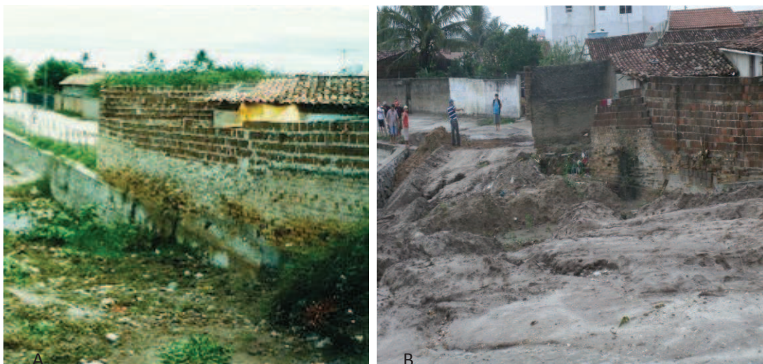
Figura 23: Casas construídas ilegalmente em terrenos públicos as margens da Lagoa
