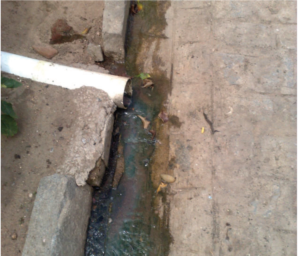
Figura 23 – Esgoto a céu aberto (Serrotão).
