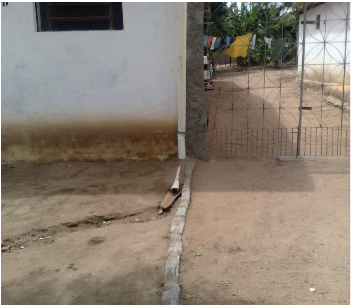
Figura 24 – Água da calha se mistura com o esgoto (Serrotão).
