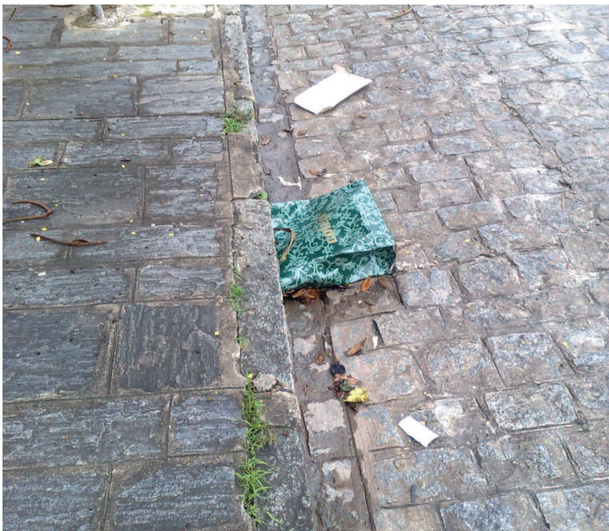
Figura 21 – Esgoto e Resíduos sólidos no meio fio (Stº Antônio).
