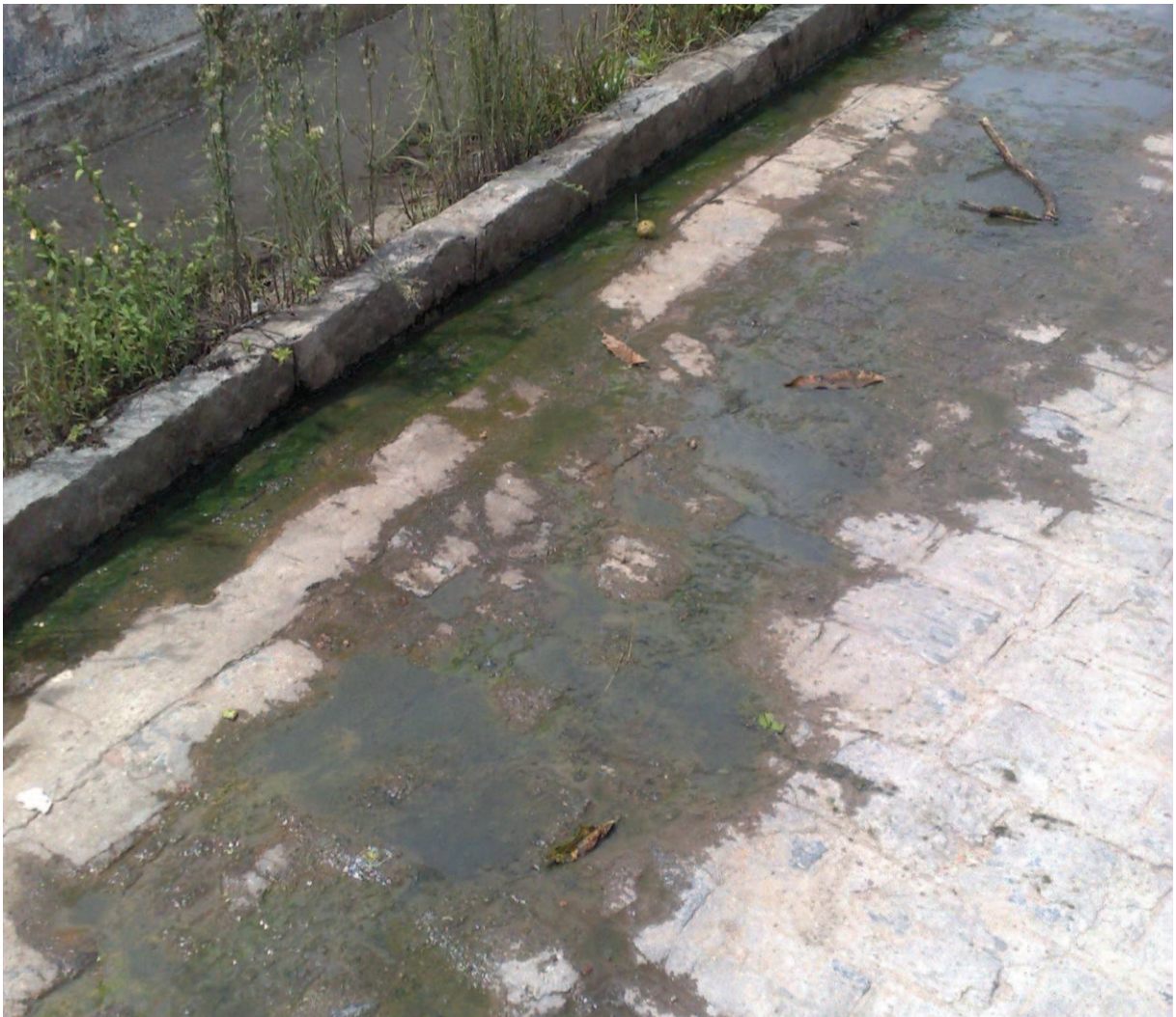
Figura 25 – Esgoto na frente do Posto de Saúde da Comunidade São Januário II (Serrotão).
