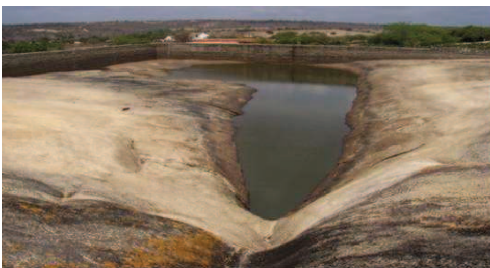
Figura 14. Tanque de Pedra natural, com intervenção de uma parede de alvenaria para aumentar o volume armazenado. Sítio Pedra Redonda, Pocinhos, PB, dezembro de 2009.
