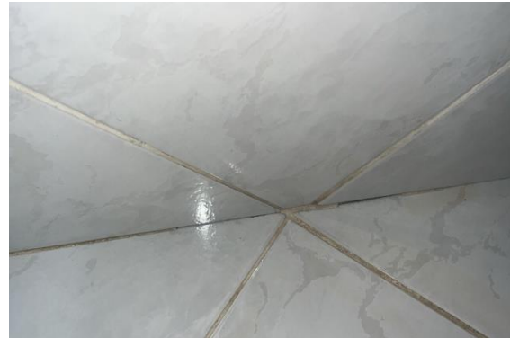
(d) Parede do banheiro
