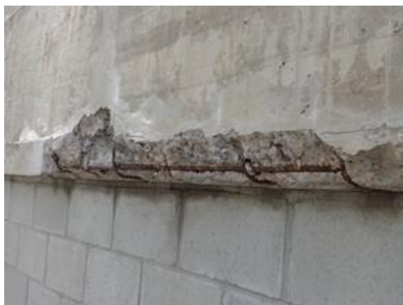
Figura 9: Corrosão de armadura
