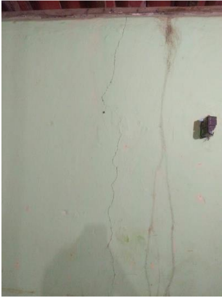
(a) Parede cozinha
