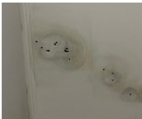
Figura 22: Forro de gesso da sala
