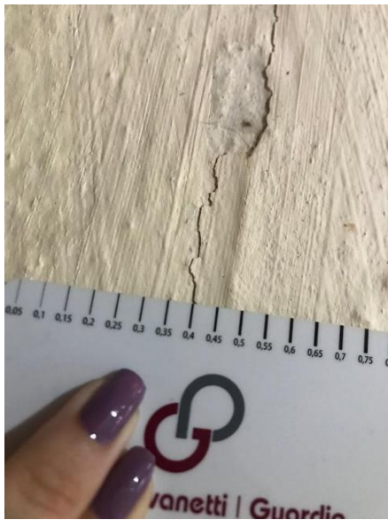
(a) Fissura em parede conjugada (corredor)
