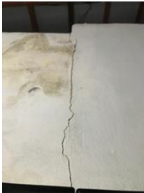
(a) Parede cozinha/banheiro
