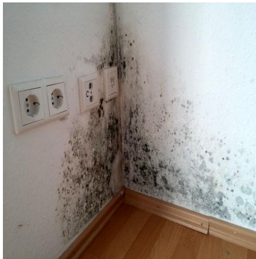
Figura 3: Mofo ou bolores na parede
