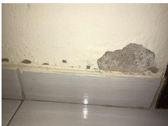
(c) Parede de divisa da cozinha com o wc social (lado da cozinha)
