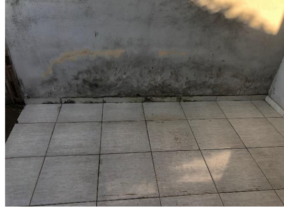
(b) Parede da garagem que faz divisa com parede do vizinho (vista inferior)
