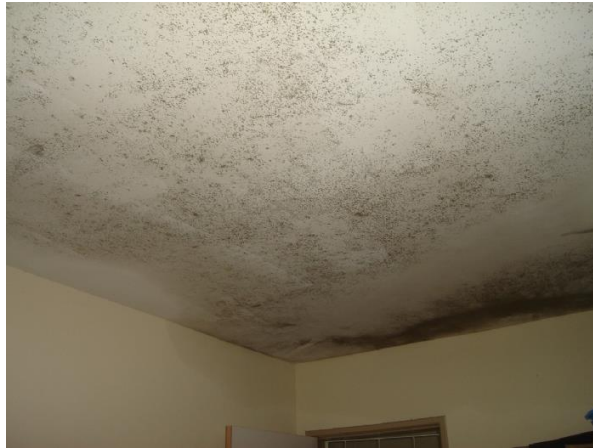
Figura 2: Mofo ou bolores na laje
