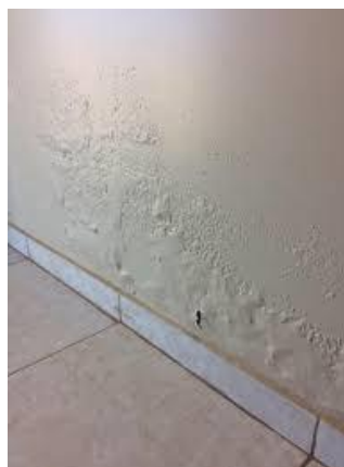
Figura 7: Umidade por capilaridade
