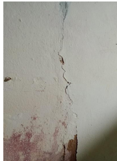
(d) Fissura corredor
