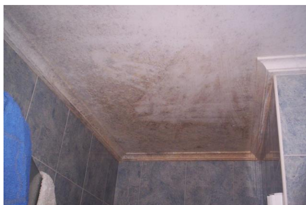
Figura 5: Umidade por condensação
