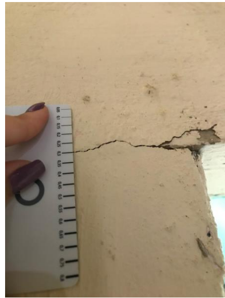
(b) Fissura em encontro de verga
