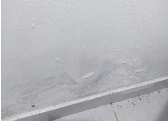
(a) Parede de divisa do quarto 02 wc social (lado do quarto)
