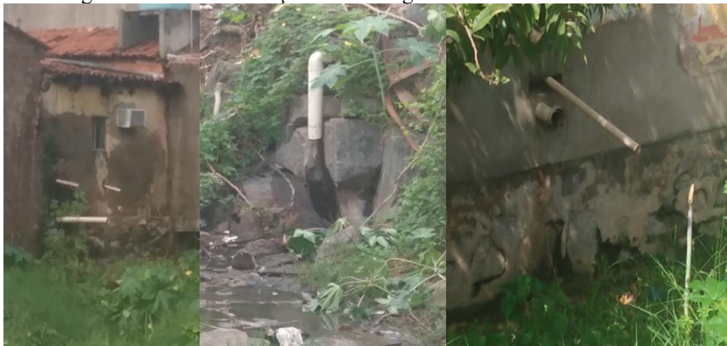
Figura 6 – Pontos de lançamento de esgoto bruto no Riacho Aroeiras
