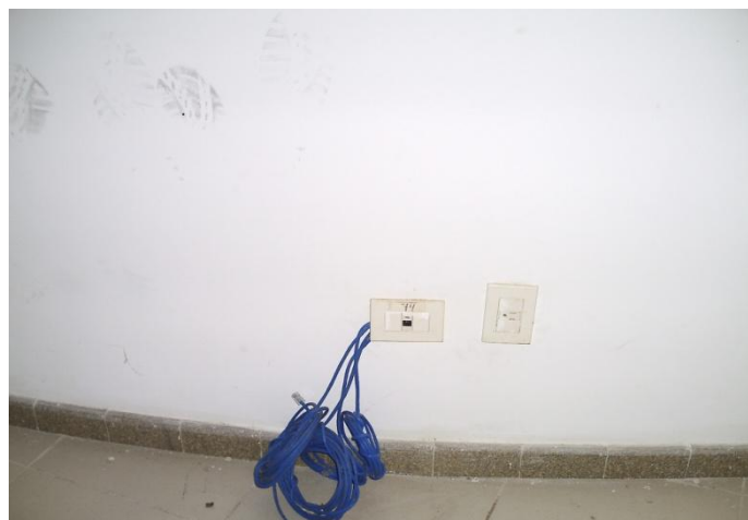
FIGURA 16: Fiação telefônica exposta – Depósito 2 FONTE: Dados da pesquisa (2010)
