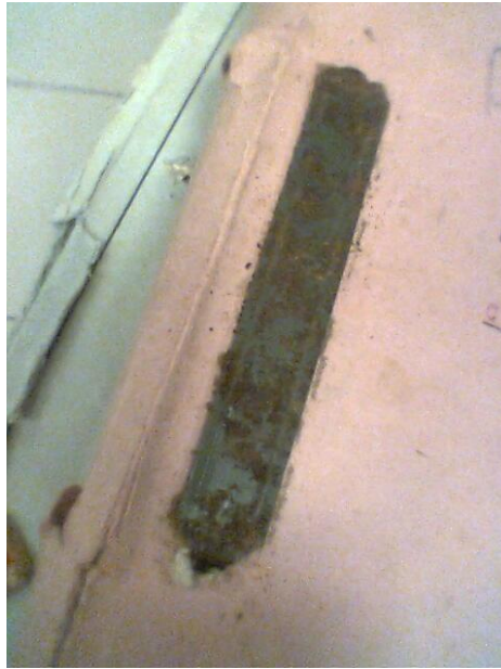
FIGURA 23: Oxidação de material metálico FONTE: Dados da pesquisa (2010)
