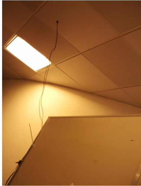
FIGURA 8: Fiação elétrica exposta – Depósito 1 FONTE: Dados da pesquisa (2010)
