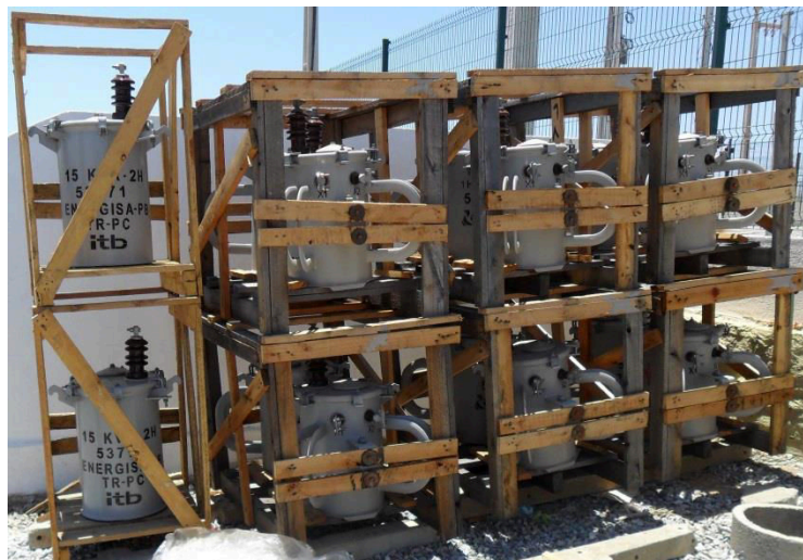
Figura 3 – Transformadores. Fonte: Pesquisa de campo, 2013.
