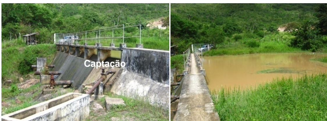
Figura 8 – Barragem de acumulação para captação de água.
