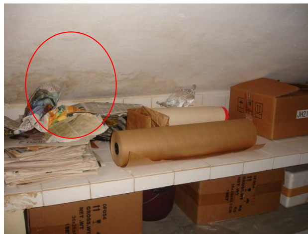
Figura 9: Infiltração nas paredes. Fonte: Dados da pesquisa, 2011.
