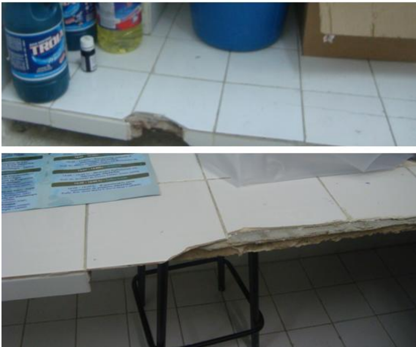
Figura 18: Bancadas quebradas no Laboratório de Histopatologia.
