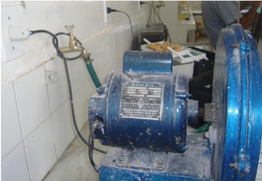
Figura 19: Recortador de gesso com instalação elétrica defeituosa.
