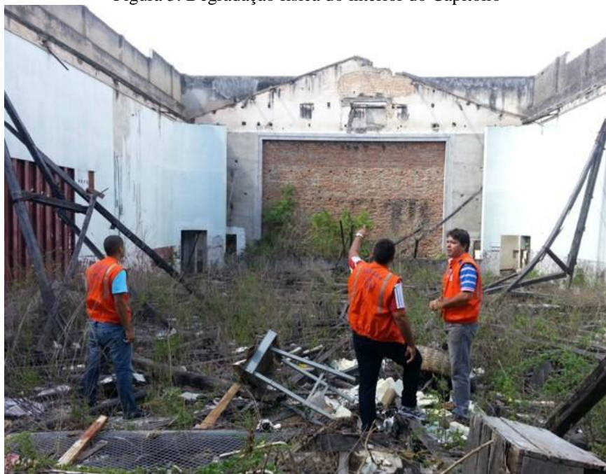
Figura 3: Degradação física do interior do Capitólio
