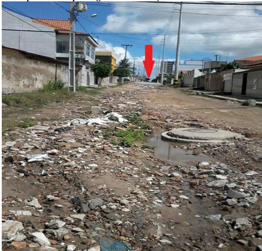
Figura 12: Rua com parte de seu prolongamento sem calçamento
