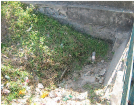
FIGURA 9: Vazamento na rede de esgoto no período de estiagem Açude João Suassuna FONTE: Pesquisa de campo, 2011
