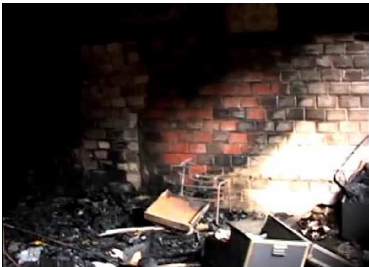
Figura 3 – Sede do grupo após incêndio.
