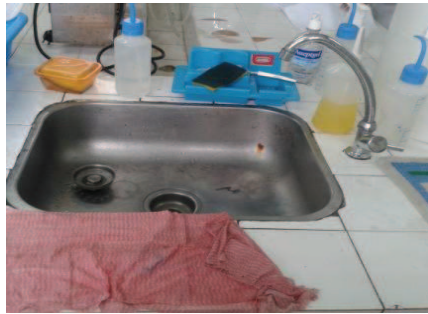
Figura 9 - Lavatório do Laboratório.
