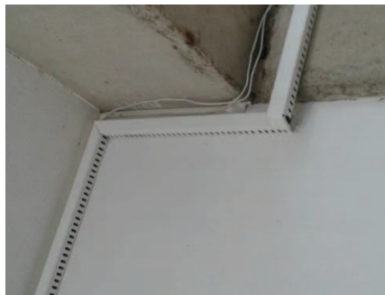
Figura 8 - Instalações Elétricas do Laboratório.
