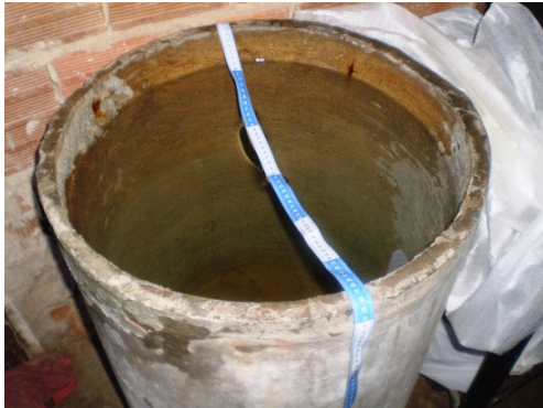
Fig. 20 Tonel de concreto.
