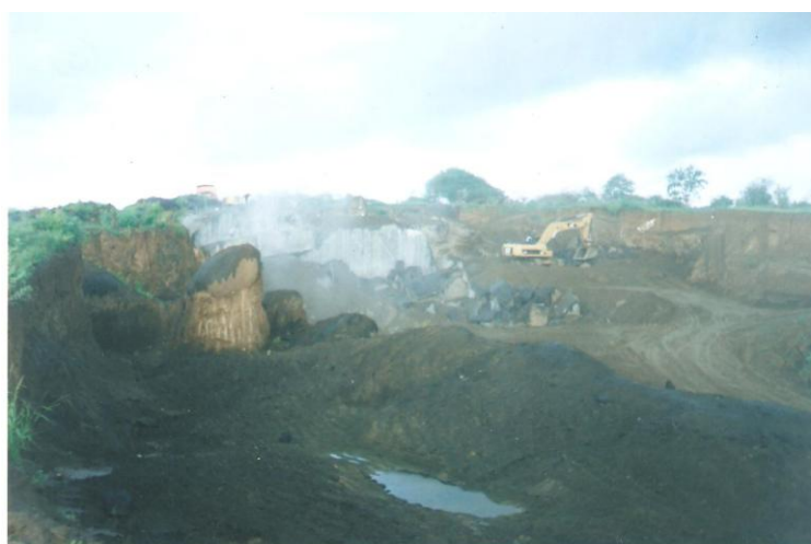
FIGURA 04: Terreno alagado por causa da retirada dos blocos.
