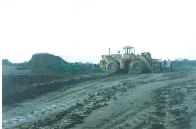
FIGURA10: Área com presença marcante de degradação.
