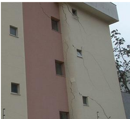
Figura 22 - Trincas em edifício.
