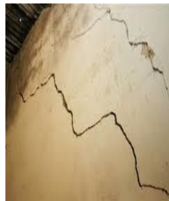
Figura 23 – Rachaduras em edifício.
