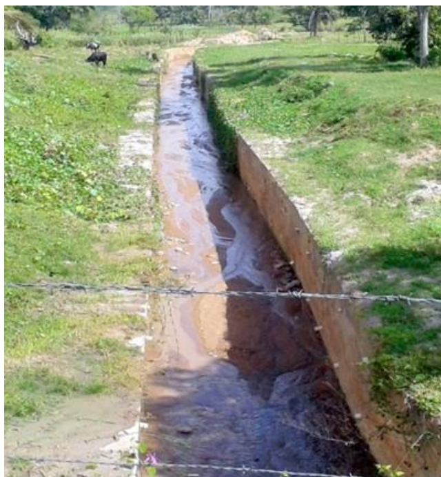
Figura 7 – Assoreamento da estrutura receptora da água proveniente do escoamento superficial
