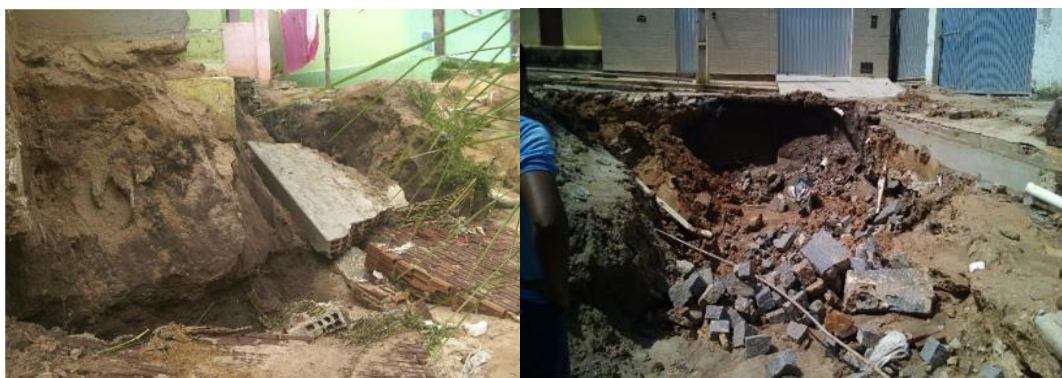
Figura 10 – Risco real de desmoronamento devido à erosão e força da água
