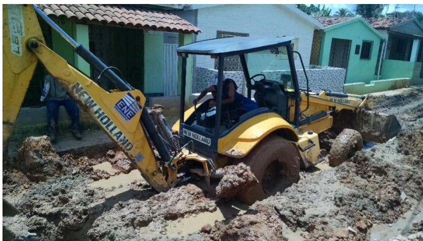
Figura 11 – Dificuldades de se executar obras de pavimentação e drenagem urbana com a presença de chuvas.
