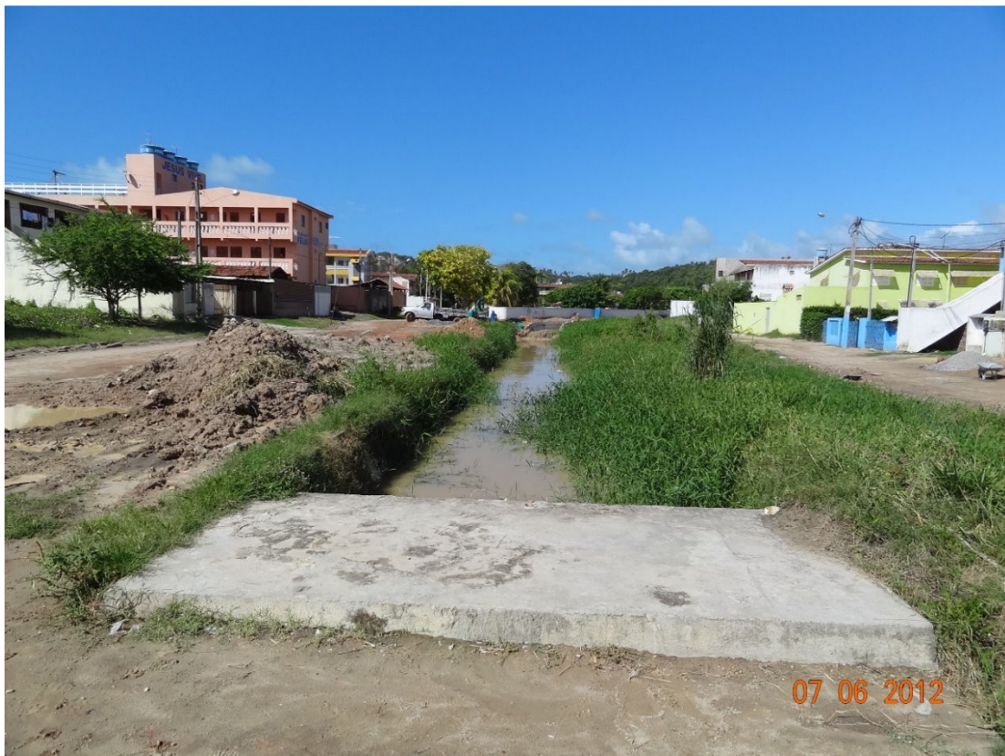
Foto 10: Bueiro celular deteriorado e com operação em déficit devido à falta de manutenção.
