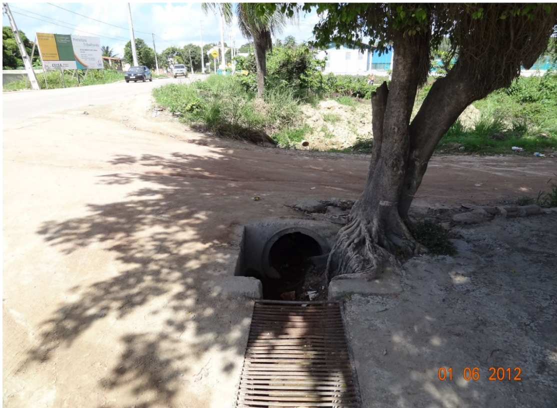
Foto 04: Bueiro tubular deteriorado devido à falta de manutenção.
