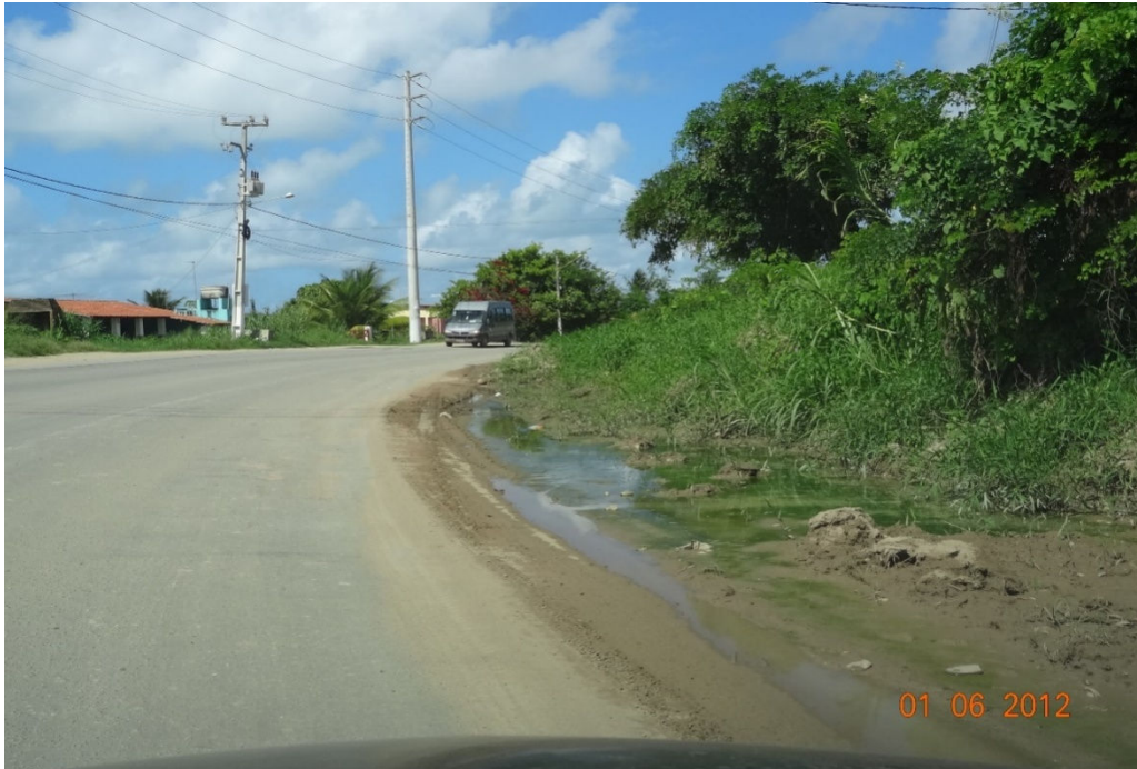
Foto 01: Acúmulo de água devido a inexistência de drenagem superficial.
