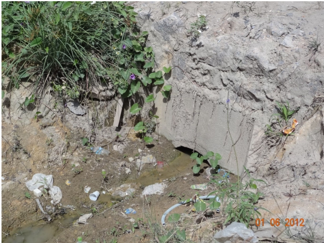
Foto 05: Bueiro tubular deteriorado e sem operação devido à falta de manutenção.
