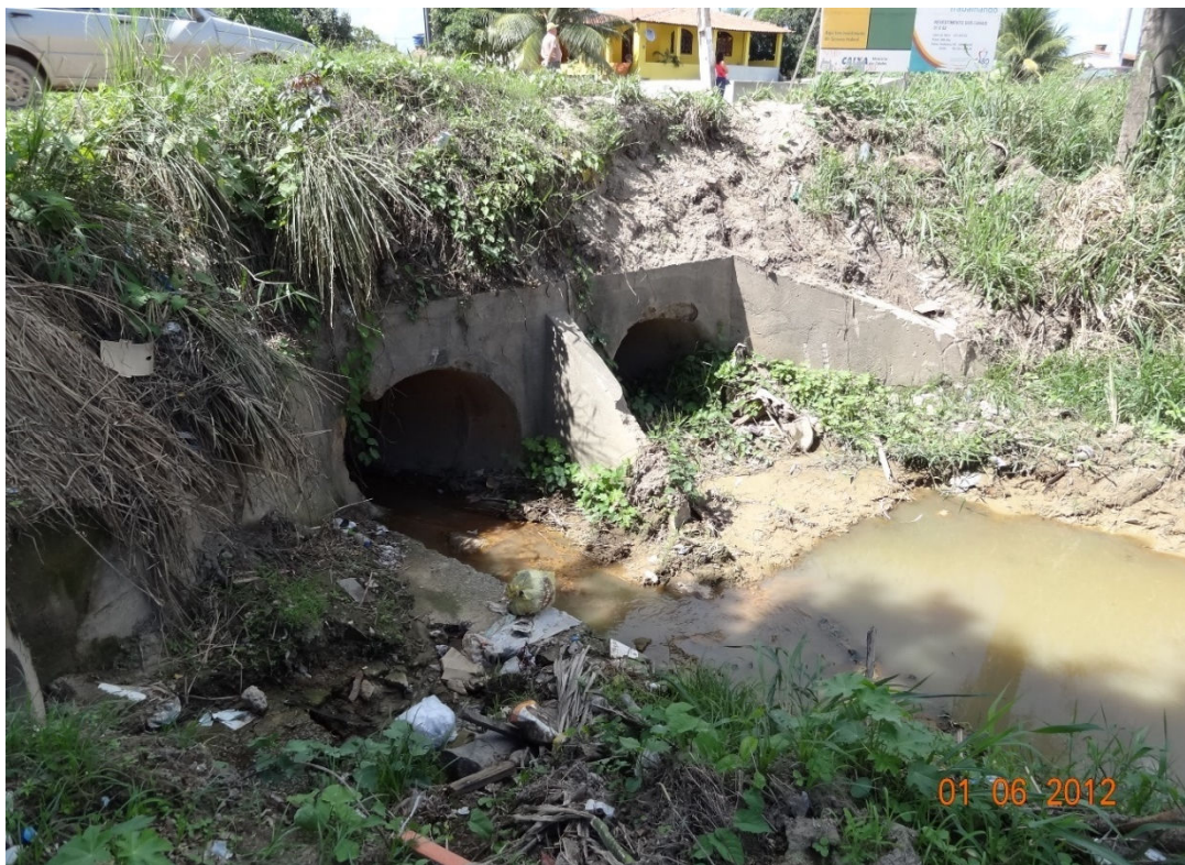
Foto 06: Bueiro tubular deteriorado e com operação em déficit devido à falta de manutenção.
