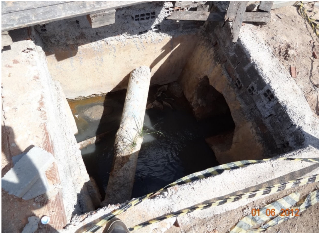
Foto 09: Bueiro tubular deteriorado e com operação em déficit devido à falta de manutenção.
