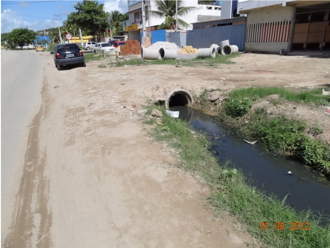
Foto 03: Acúmulo de água devido problema com desague.
