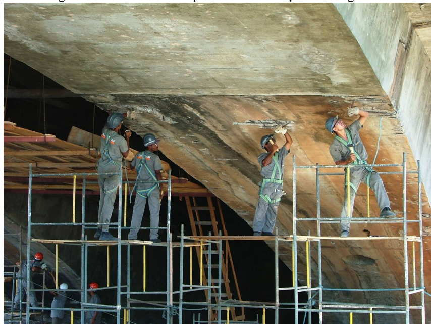
Figura 10 – Buzínates entupidos e carbonatação nas longarinas.
