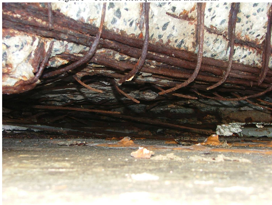
Figura 5 – Corrosão eletroquímica das armaduras.
