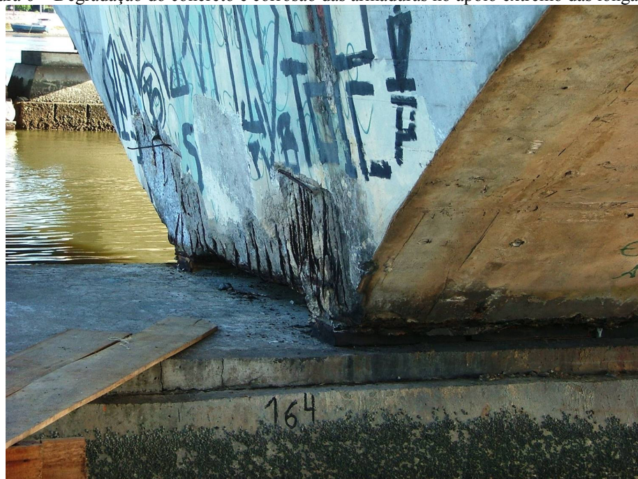
Figura 6 – Degradação do concreto e corrosão das armaduras no apoio extremo das longarinas.
