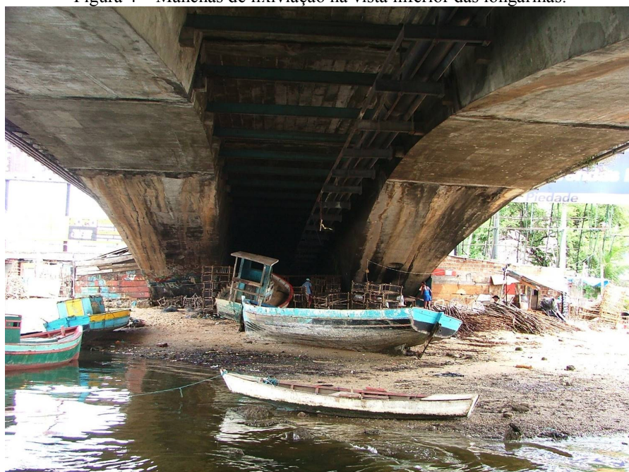
Figura 4 – Manchas de lixiviação na vista inferior das longarinas.
