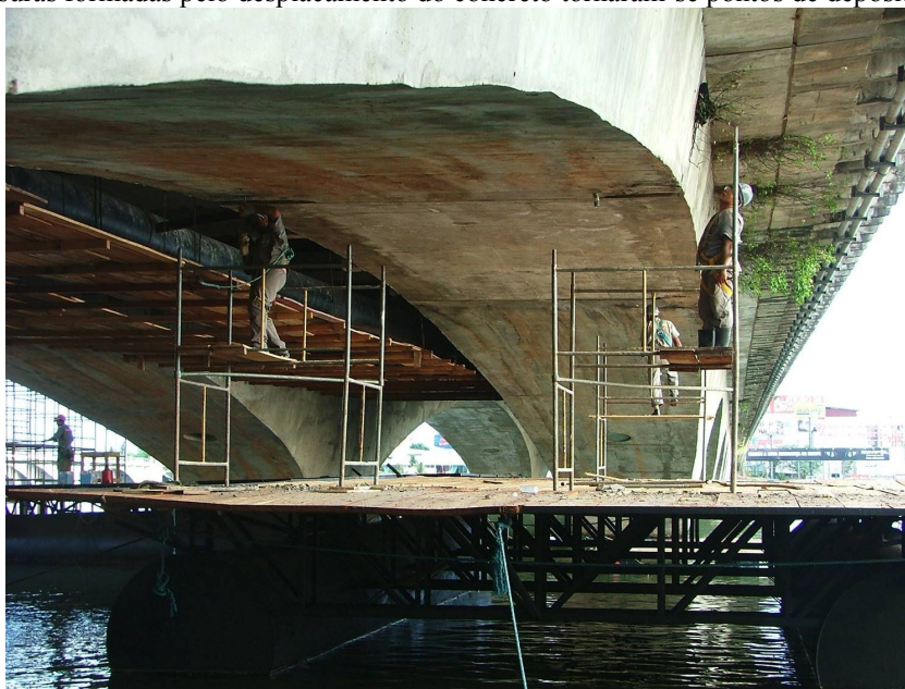
Figura 8 –Fissuras formadas pelo deslocamento do concreto tornaram-se pontos de depósito de sedimentos.
