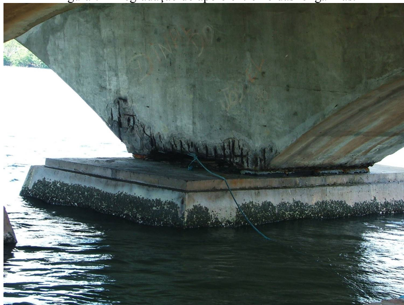
Figura 7 – Degradação do apoio extremo das longarinas.
