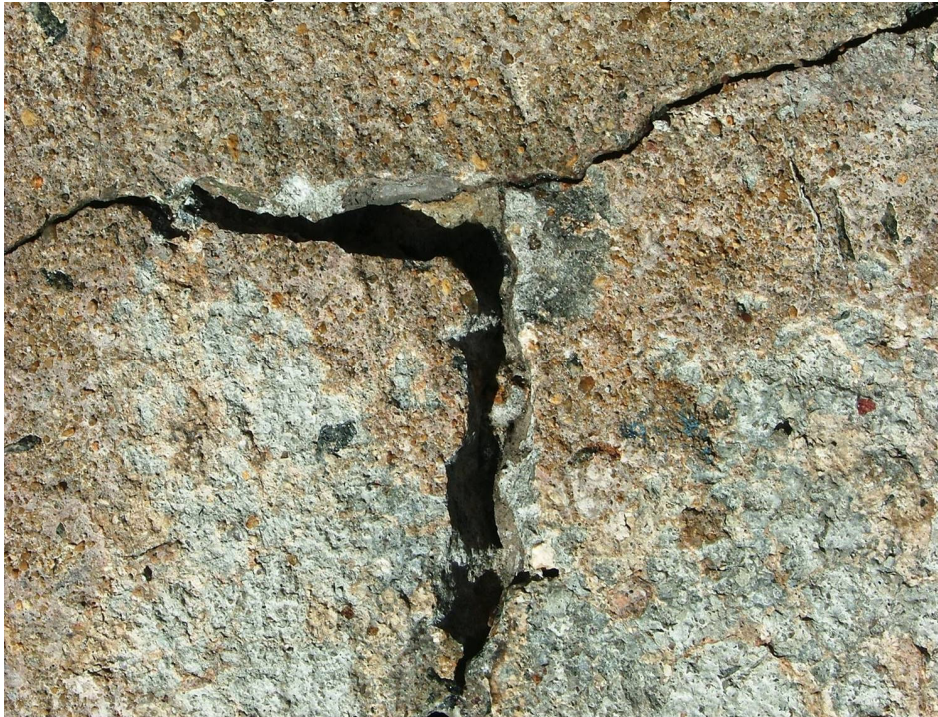
Figura 9 – Fissuras nos blocos de fundação.
