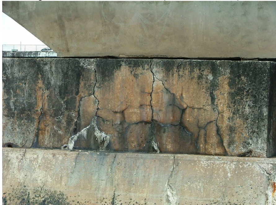
Figura 3 - Fissuras e manchas de lixiviação no bloco de fundação.
