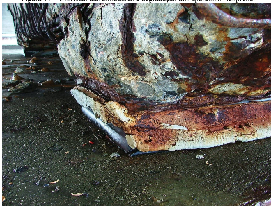
Figura 11 – Corrosão das armaduras e degradação dos aparelhos Neoprene.
