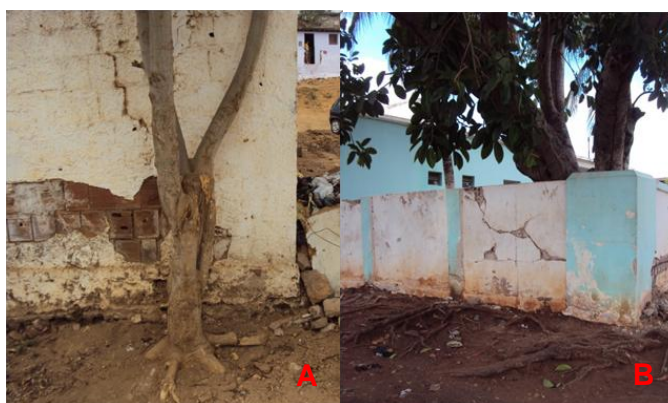
Figura 15. Danos provocados em muros (A) e construções (B) da cidade. Boqueirão/PB, 2013. Foto. Maria Virgínia Kelly Ferreira da Silva.
