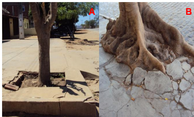
Figura 8. Danos provocados às calçadas na cidade de Boqueirão/PB, 2013. Foto: Maria Virgínia Kelly Ferreira da Silva.
