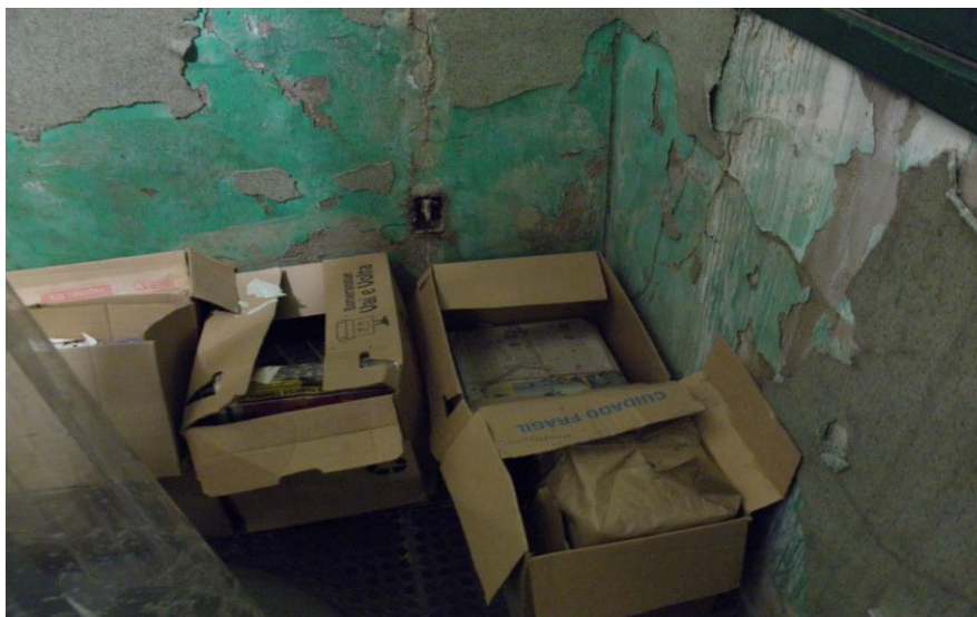
Figura 3 - Parede com mofo, traças e vestígios de circulação de insetos.
