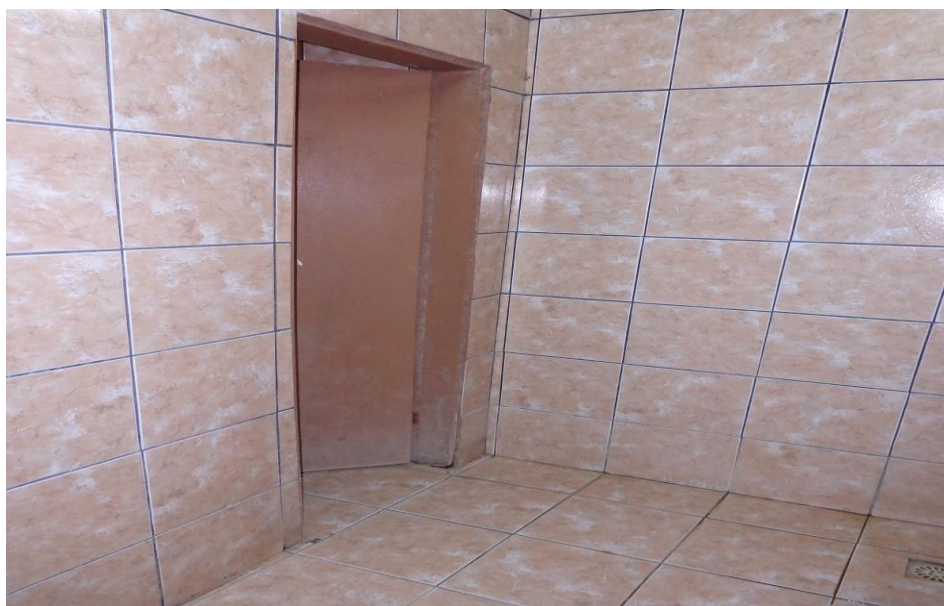
Figura 4: Entrada do banheiro: porta estreita
