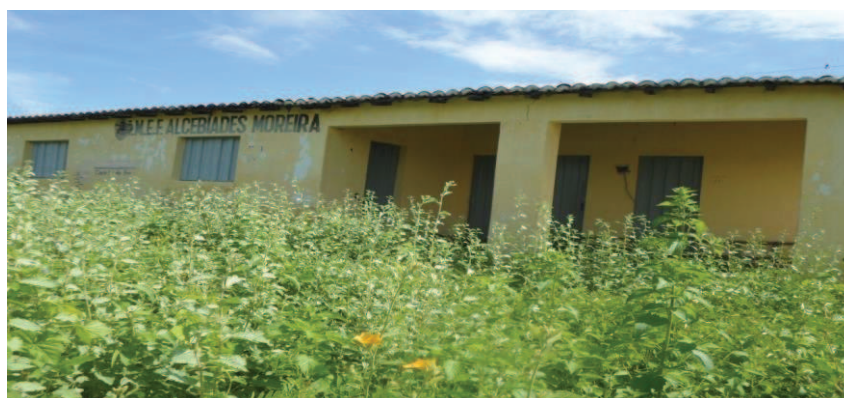
Figura 6 -Escola Rural de Ensino Fundamental Alcebiades Moreira (fechada). Fonte: Acervo pessoal do autor.
