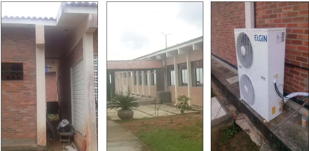
Figura 15 – Unidades condensadoras das clínicas 01, 02 e 03 respectivamente.
