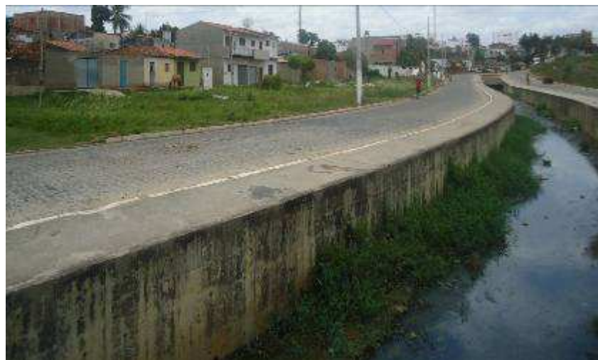
Figura 2 – Aspecto do canal localizado no bairro do Juá. Fonte: Ana Carolina Rodrigues, novembro de 2011.
