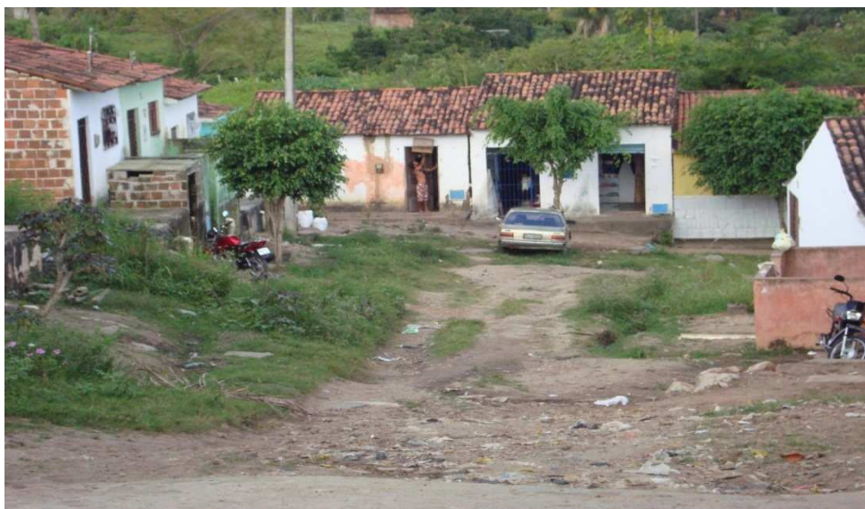
FOTO: Rua sem pavimentação. FONTE: FELICIO - 2011
